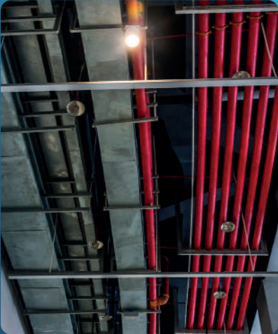
YANGIN TESİSAT UYGULAMA
